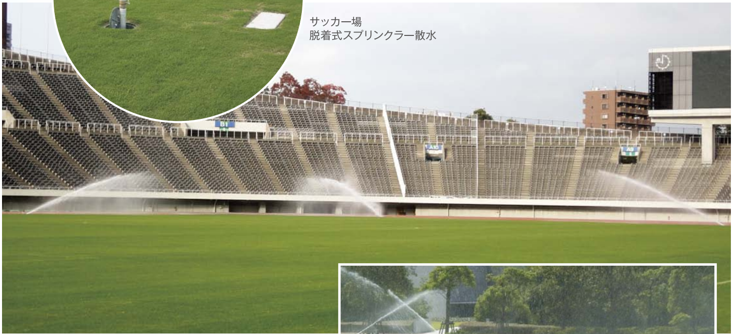
サッカー場 ポップアップスプリンクラー散水
